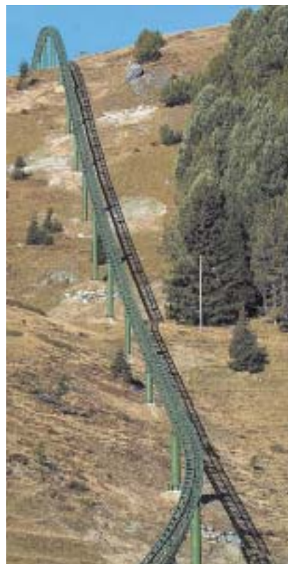
Abklärungen im Gang: Am Trasse des Coasters müssen Mängel behoben werden.
